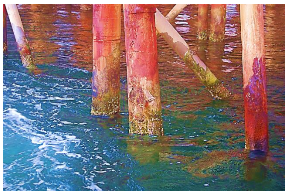
Рисунок 4 – Морская платформа С-9 в Балтийском море и коррозионные повреждения ее опор
