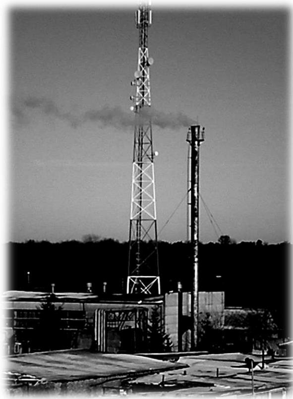
Рисунок 1 – Котельная в г. Зеленоградске Калининградской области
