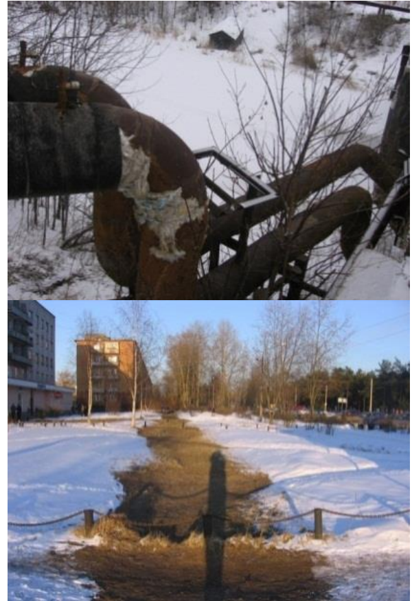
Рисунок 1 – Трубы Ду 300 без изоляции под мостом и прогалины на месте теплотрассы
